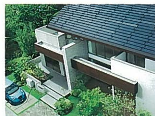
太陽光発電システム
